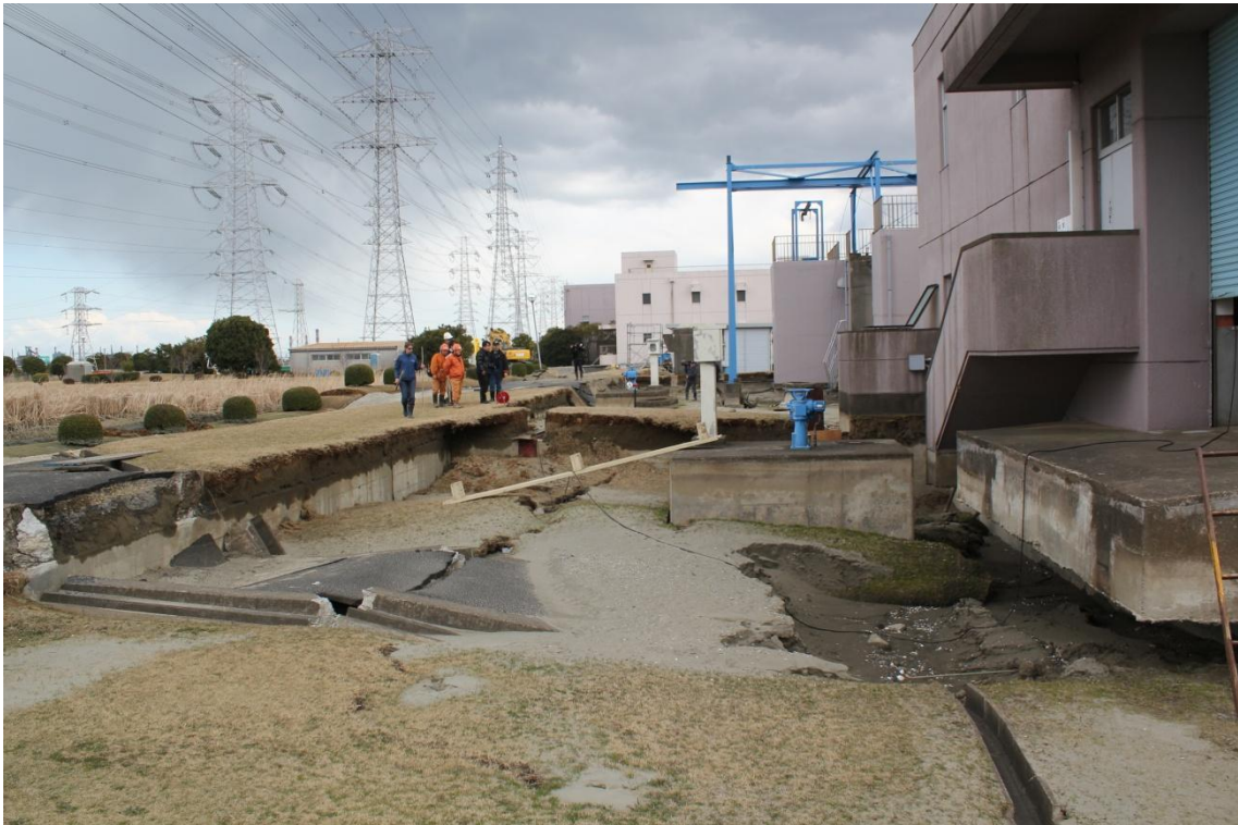
Estructuras hundidas por la licuefacción. Foto: Scott Ashford, Oregon State University
